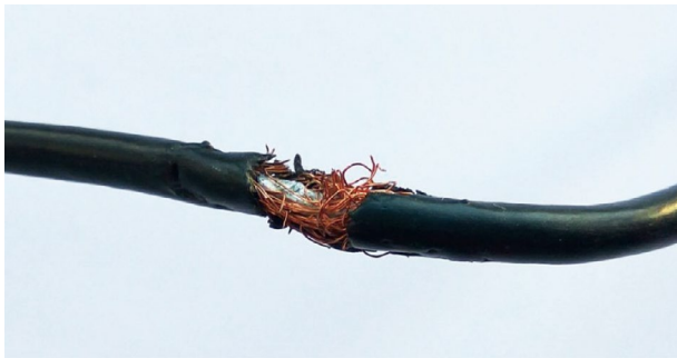
圖 7: 電線損壞可導致短路以及其他電氣問題
